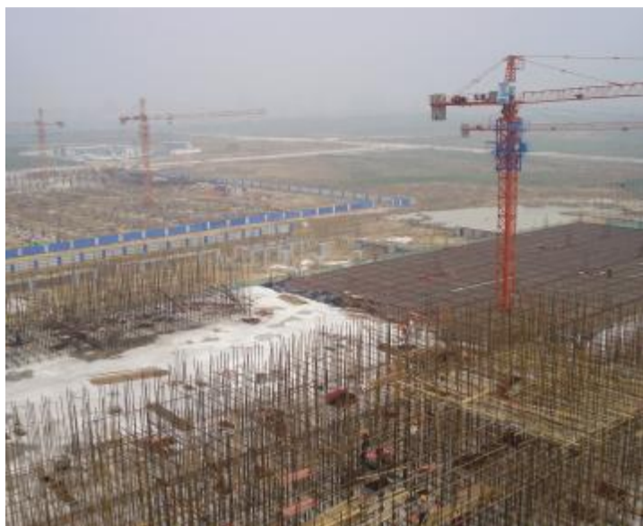
正在紧张施工中。所有工程建设及设备安装工作将在2008年2月中旬前全部完工。(通讯员 余勇)
